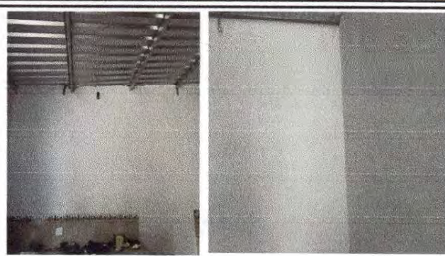
Foto 14 : Repello en paredes de los ambientes de la cocina y de la dirección.
